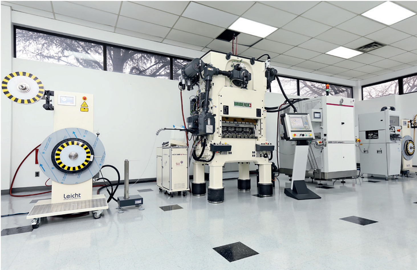
Impianto di tranciatura Facet.
